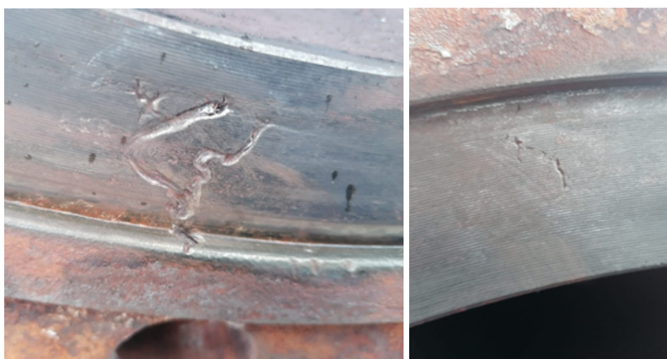
Рисунок 3. Деформация металла на фланце арматуры в месте образования паропотечки
