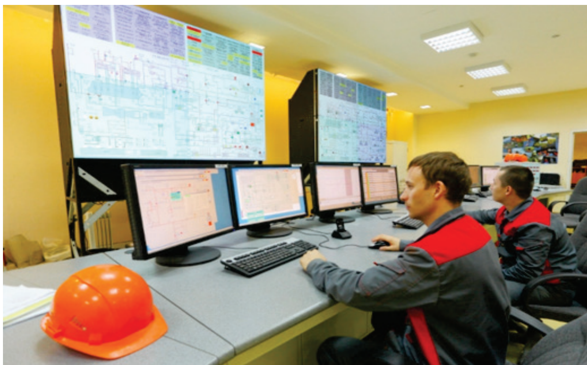
Рис. 1.2. Современное управление энергоблоком ТЭЦ
