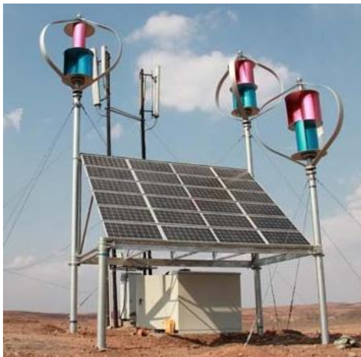
Комбинированная ветро-солнечная энергоустановка
