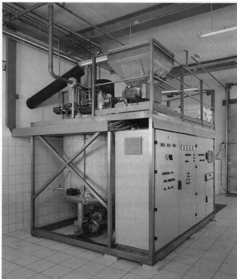
Рис. 9.4. Крахмальная варочная установка
