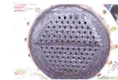
Рис. 2. Загрязнения трубного пространства кожухотрубного теплообменника
