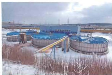
Рис. 4. Флотаторы для сгущения избыточного активного ила перед обезвоживанием.
